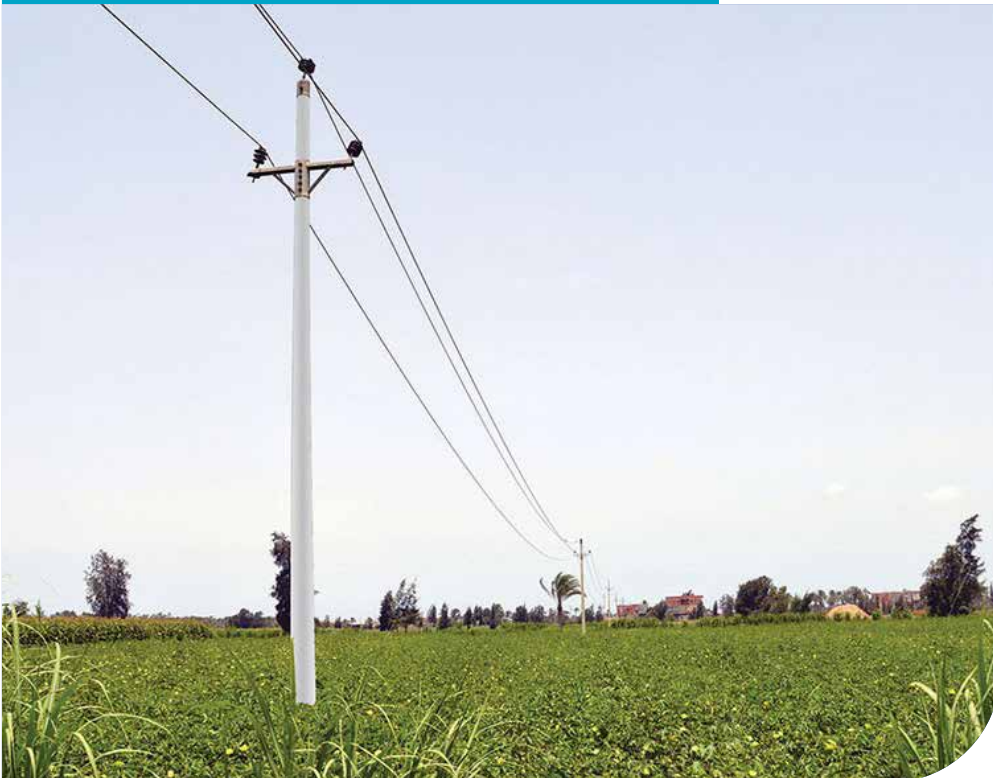
Poteaux de transport d'électricité
