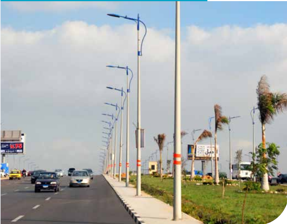
Poteaux d'éclairage public
